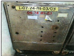
Chiller Air เครื่องทำน้ำเย็นเครื่องจักร
