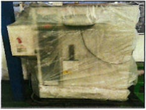
แอร์ทำความเย็นตู้คอนโทรล Robot
